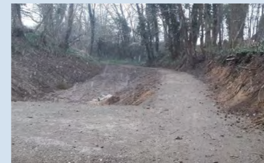
▲ L'un des 2 bassins de retenue et d'infiltration, chemin des Glaises.
